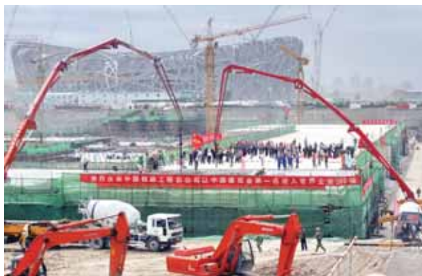
● 中铁电气化局承建的北京地铁奥运支线奥林匹克公园站如期封顶
